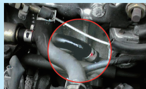
亀裂から燃料漏れをおこした燃料ホース
